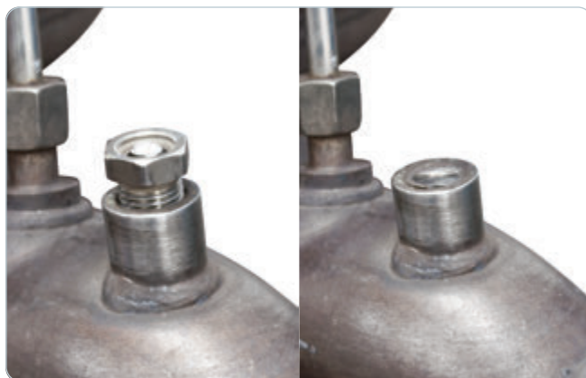
2. Links: Nach Entfernen der Sensorleitung Rechts: Temperatursensor entfernt, Gewinde defekt
