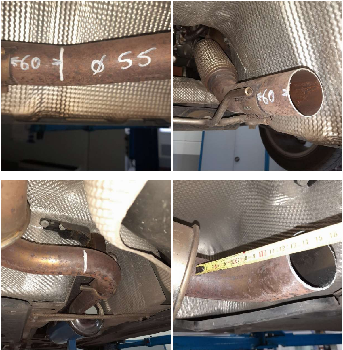
Abbildung 39: VW Passat - Vorbereitung des Einbaus: Schnittstellen nach DPF des Herstellers (oben) und vor Mittelschalldämpfer des Herstellers (unten).
