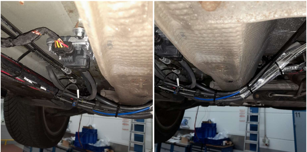
Abbildung 42: VW Passat – SCR-System nach Isolierung von Heizung und NO x -Doser.
